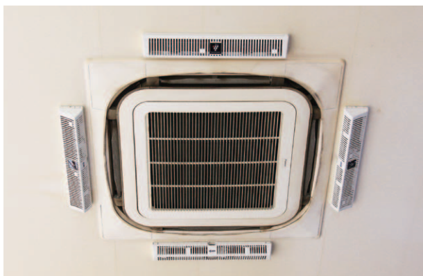
天井の空調周辺に設置された『PCI発生ユニット』
